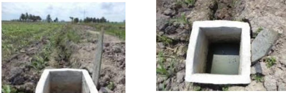
Gambar 5 . Bangunan pengendali ( box control ) terhubung dengan kolektor pipa
